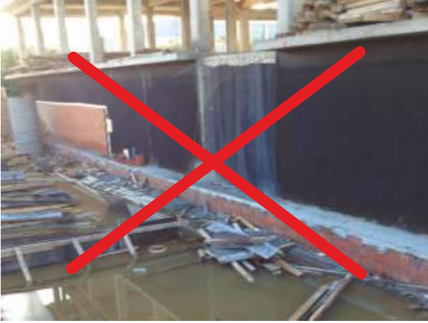
İskele Kurulmaya Uygun Olmayan Zemin
